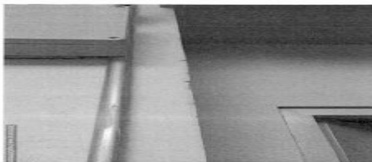
Terminación de acabado en esquinas de columnas con mortero, inconclusas.
