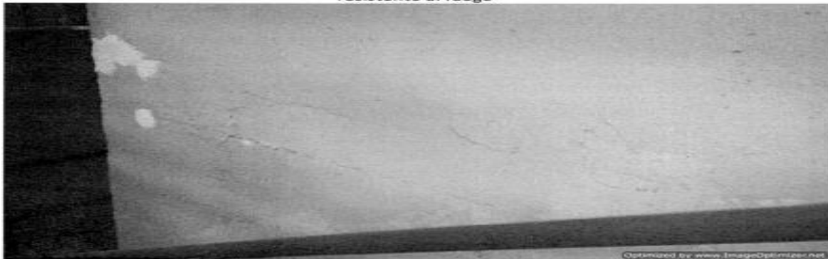
Falta mejorar acabado de solaqueado de placa de ascensor montacarga, reparar cangrejas visibles
