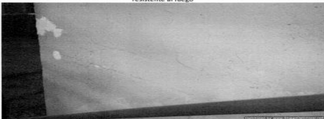
Falta mejorar acabado de solaqueado de placa de ascensor montacarga, reparar cangrejerías visibles
